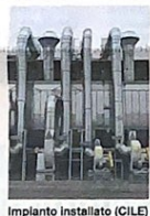
Impianto installato (CILE)
